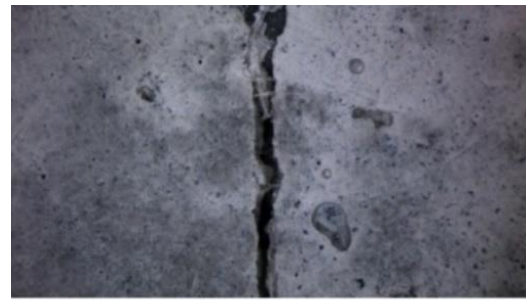
В бетоне обнаружена трещина
